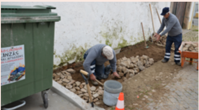
NISA Construção de gare para caixotes do lixo na Rua de São Tiago
